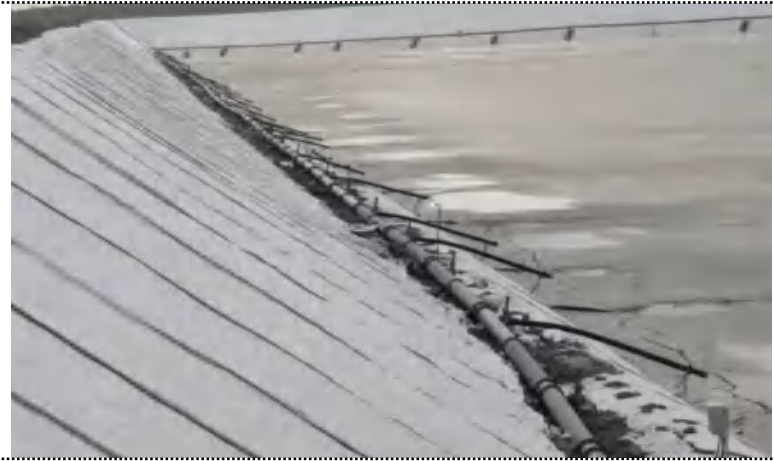
尾矿输送管线
