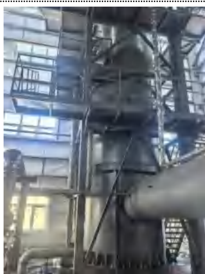
热风炉脱硫塔
