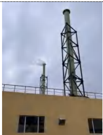
酸性、碱性废气排气筒
