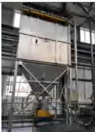
原料车间除尘器
