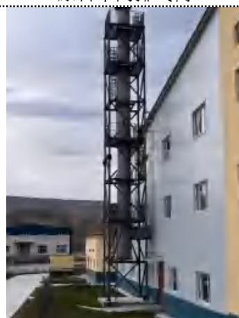
焙烧车间燃烧废气排气筒
