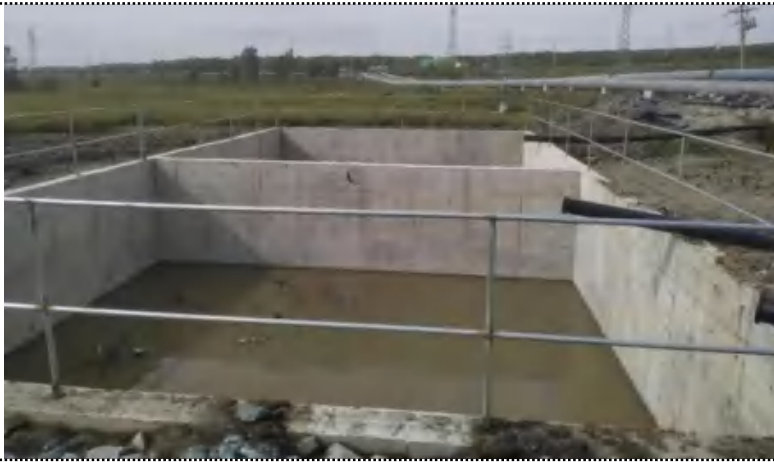
2 座 300m 3 事故池
