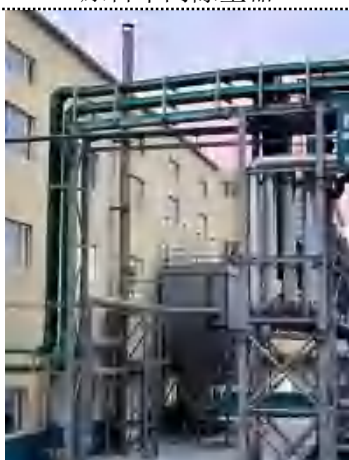
焙烧车间破碎筛分除尘器、排气筒
