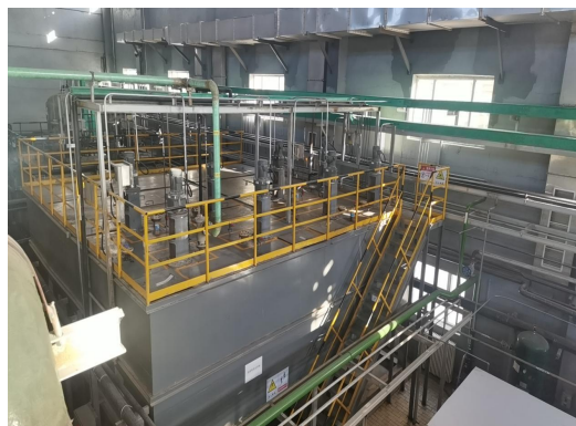
生产废水处理系统
