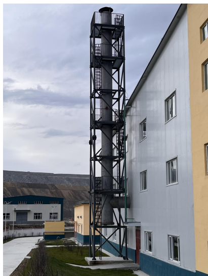
焙烧车间天然气燃烧废气排气筒
