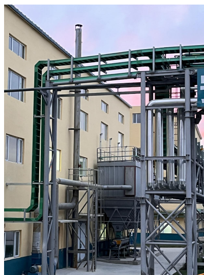
焙烧车间破碎筛分废气除尘器及排气筒
