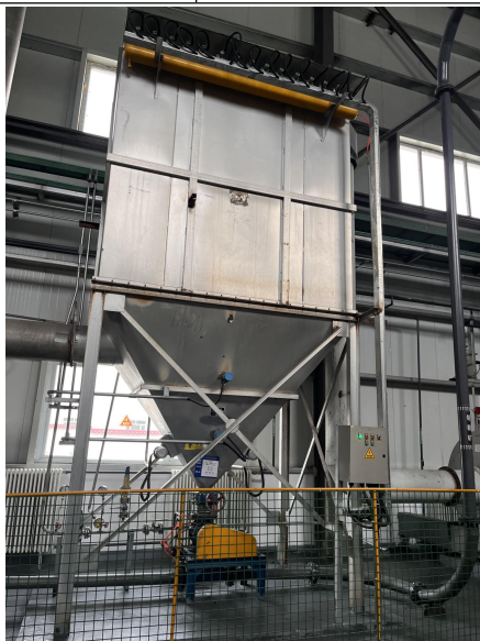
原料车间除尘器
