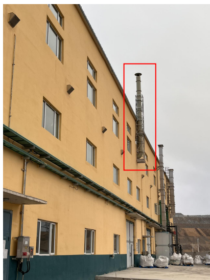
废水处理车间废气排气筒
