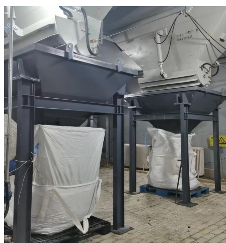
污水处理站污泥压滤下料口
